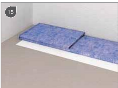
15 Poter by mal zasahovať až k 2cm širokej prednej hrane polystyrénového bloku
